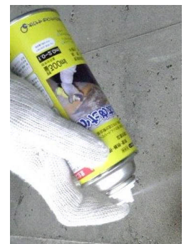
逆さ吹き状況
